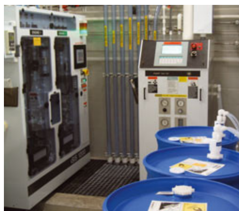
Entegris 化学薬品供給ソリューションを使用すると、危険な混合作業に対応し、化学薬品の完全性を確保することができます。写真提供、Cypress Semiconductor Corporation。
